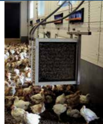
DER WÄRMETAUSCHER sorgt u. a. für die entsprechende Temperatur.
