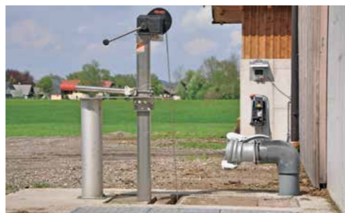
UNTERHALB DES FRESSBEREICHES befindet sich der 110 m 3 große Güllekeller, außerhalb Rührwerk und Absaugstation.
