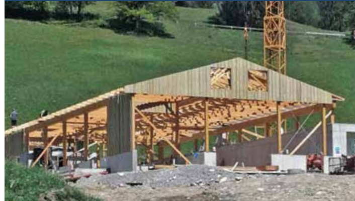
IN NUR NEUN TAGEN konnte die Holzkonstruktion mit Nagelplattenbindern errichtet werden, das ist auch der hohen Eigenleistung zu verdanken.
